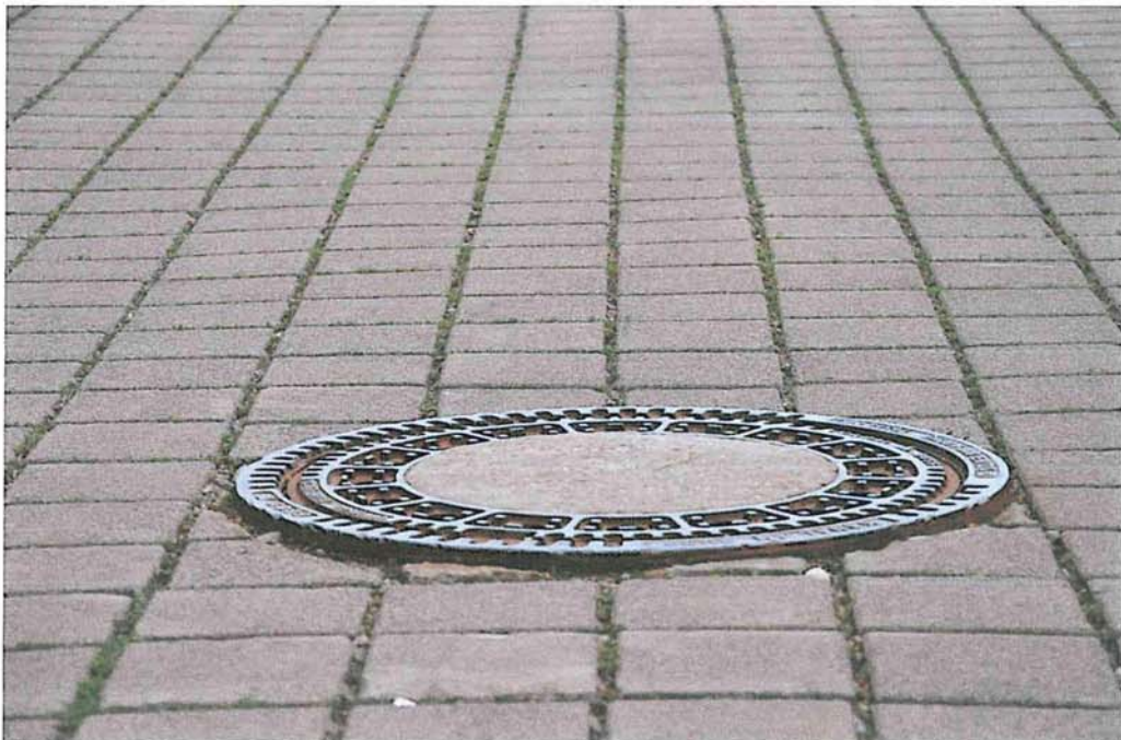
Bild 5: Absenkung der Straße durch Verdichtung des Untergrundes (Deckel scheinbar angehoben)
