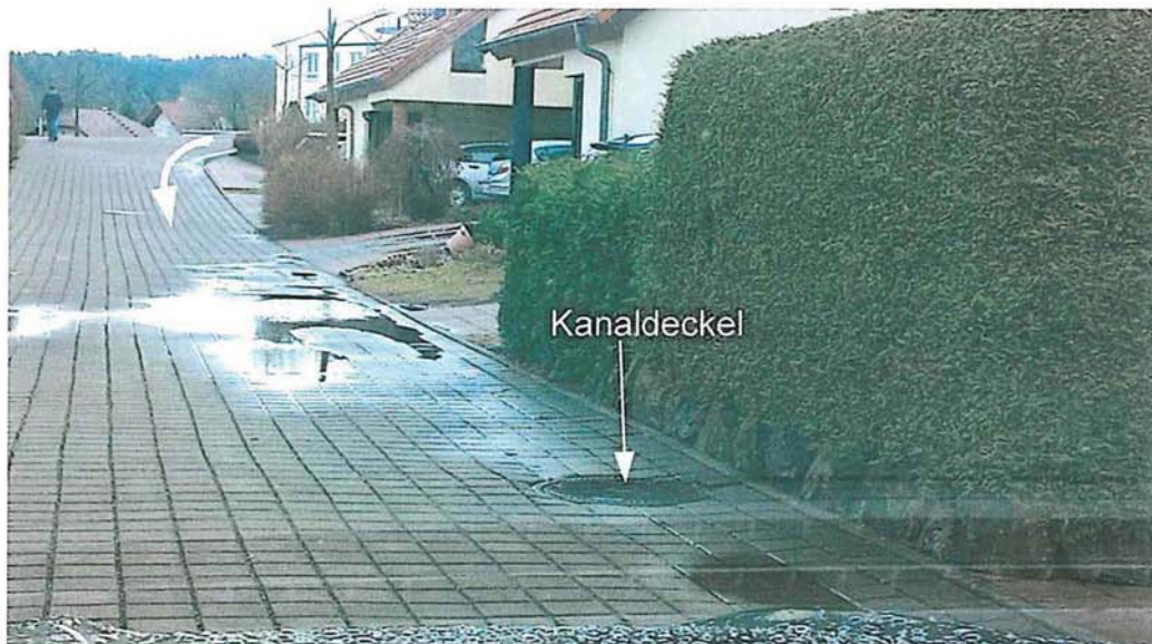
Bild 4: Restwasserstand, nach starkem Regen Wasser kann nicht normal abfließen; Versickerung nur sehr langsam fortschreitend; an Straßeneinmündung (im Bild oben): Wasserlauf von oberem Straßengebiet erkennbar (Pfeil)
