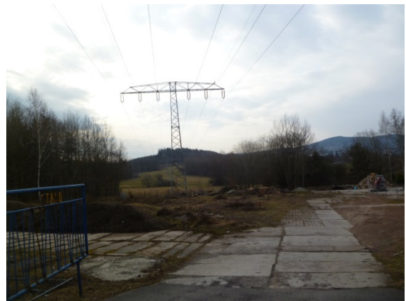
Freigestellte Hochspannungsleitung (110 kV)
